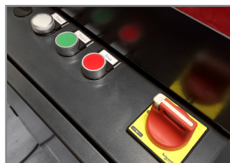
PANNELLO DI CONTROLLO CONTROL PANEL
