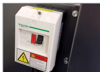
INTERRUTTORE GENERALE MAIN POWER SWITCH
