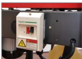
INTERRUTTORE GENERALE MAIN POWER SWITCH
